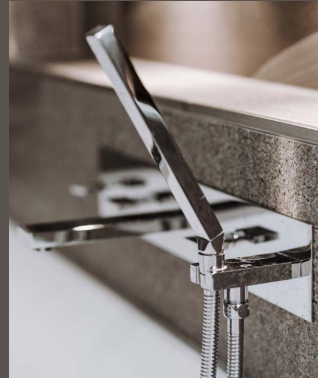
Unterputz-Designelemente in allen Bädern
